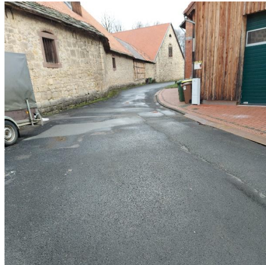
Abbildung 29: Burgtwete mit Straßenschäden und Mülltonnen auf dem Gehweg, der weiter hinten endet Bild: B.A.U.M.
